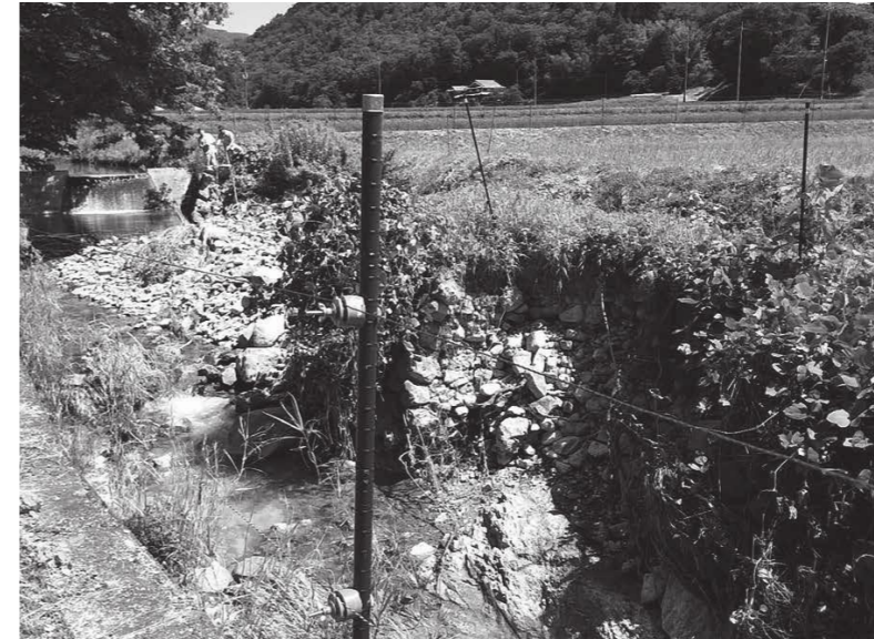
崩落した護岸(大谷川・槻並)
