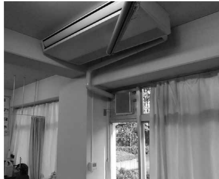
一部の教室で設置されている空調設備
