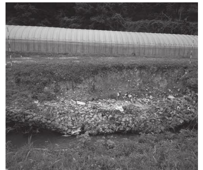
崩落した護岸(仁部川・槻並)
