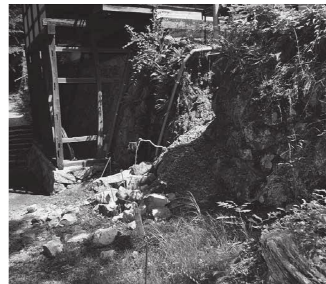
境内の石垣が崩れた金山彦神社(银山)
