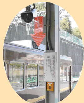
非常通報ボタン (ホーム)
