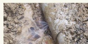
図3：経年劣化により漏水した塩化ビニル管
