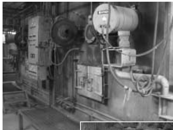
▲クリーンセンターごみ焼却炉
