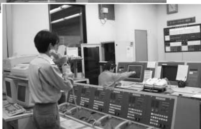
共同運用となる消防通信司令室
