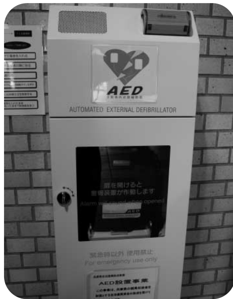
公共施設に設置されているAED(町役場)
