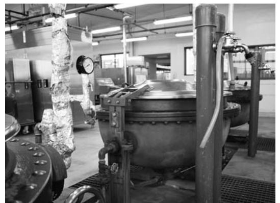
老朽化が進む給食センターの調理機器
