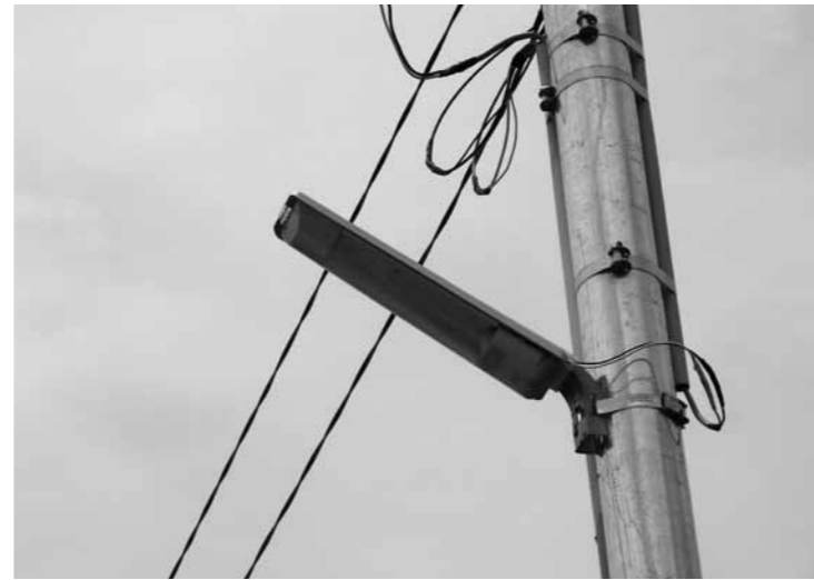
紫合地内の通学路に設置されているLEDの防犯灯
