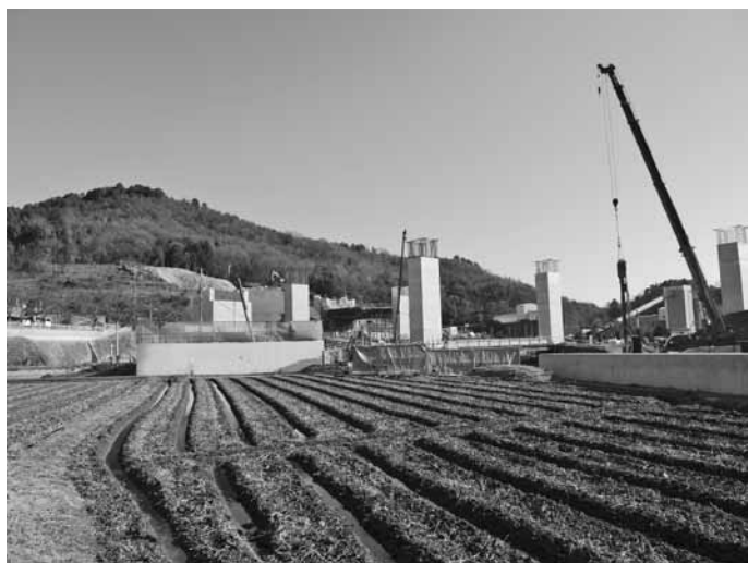
広根地区から見た新名神高速道路六石山トンネル出口付近の現状
