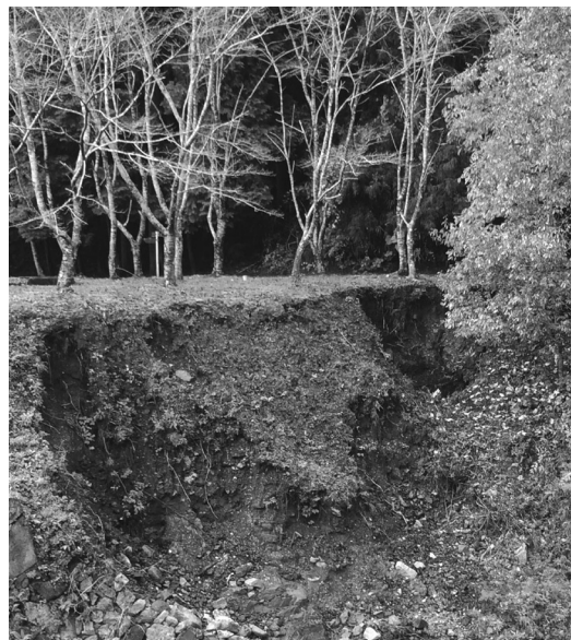
豪雨災害で崩れた石垣
