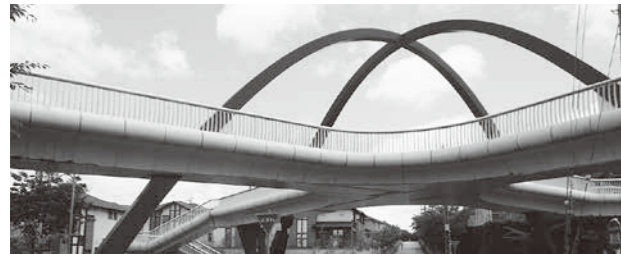
老朽化が進む白金キラキラ橋
