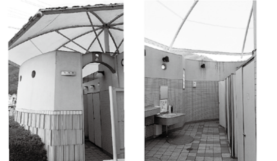
改修が求められる道の駅内のトイレ
