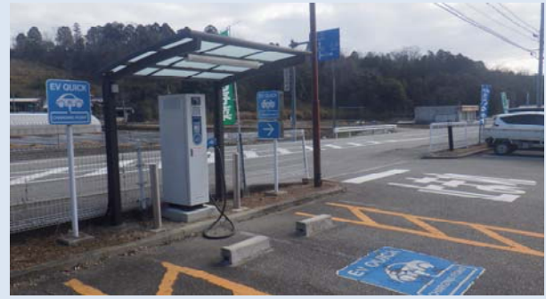
公共施設に配備されている電気ステーション
