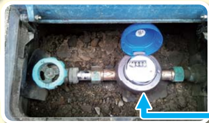
水道メーター
