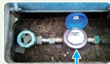
水道メーター
