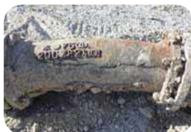
破損した水道本管
