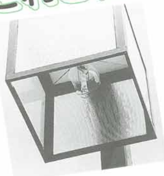
▲照明灯(総合公園) 公園を照らすための照明灯が割られています。
